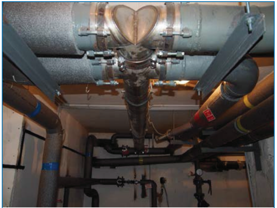
Рис. 2. Шестиэтажный 8-подъездный жилой дом в Нижнем Тагиле, теплообменник ГВС расположен под потолком подвала.
