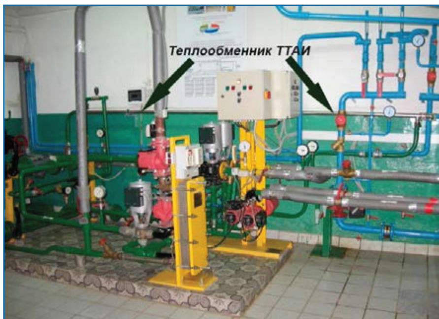
Рис. 3. «Планшетный» ИТП полностью размещён в плоскости стены и практически не занимает места в плане. На переднем плане – «старый» ИТП с пластинчатыми теплообменниками, который был заменён планшетным ИТП.
